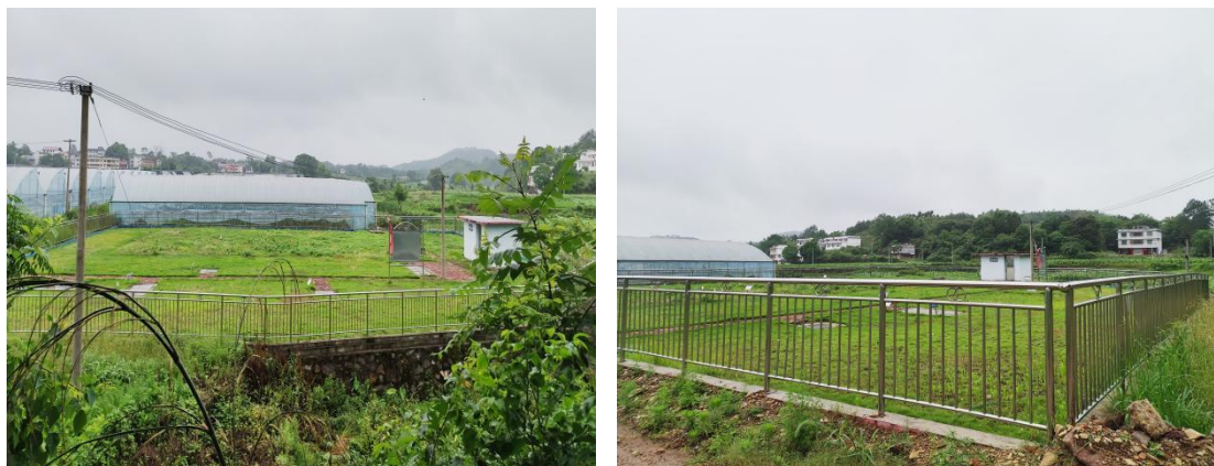
图3-3 赣江源镇生活污水处理设施
